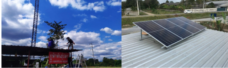
ภาพที่ 3 การติดตั้งระบบผลิตไฟฟ้าพลังงานแสงอาทิตย์สำหรับใช้ในระบบเติมอากาศของบ่อเลี้ยงปลา
