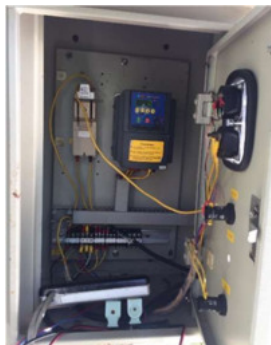
ภาพที่ 5 ตู้ควบคุม สำหรับควบคุมระบบไฟฟ้าของเครื่องสูบน้ำ
